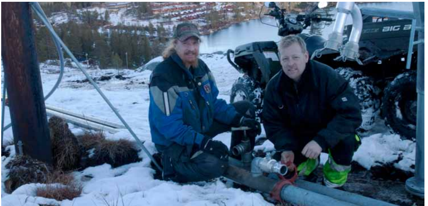
Arve Hafslien (til venstre) er fast ansatt på Fagerfjell Skisenter. Her skrur han og Rolf Eric Storebaug på koplignene til de nye snøkanonene.
